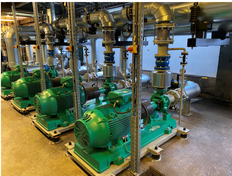
Fotografia 3. Pompy obiegowe PO1 – PO4 WILO-Atmos GIGA-N 80/200-55/2
