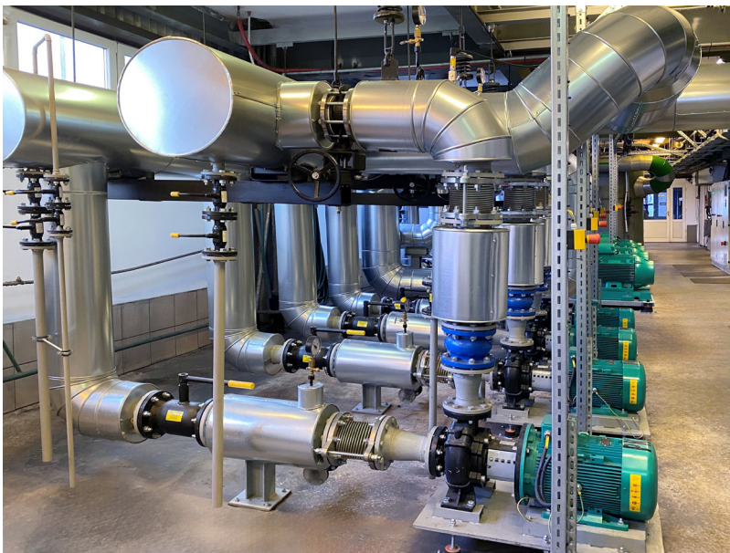
Fotografia 2. Pompy kotłowe K1- K4 WILO-Atmos GIGA-B 80/140-18,5/2
