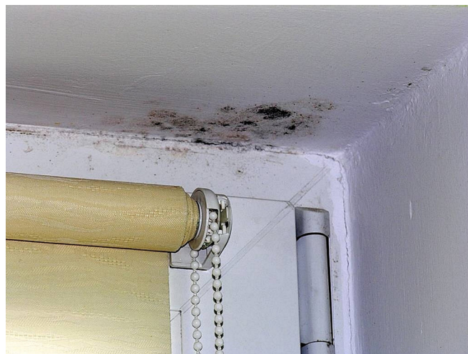
Fotografia 2. Przykład pleśni w nadprożu okna. Źródło: opracowanie własne Photo 2. Example of mold in a window lintel. Source: authors' own study
