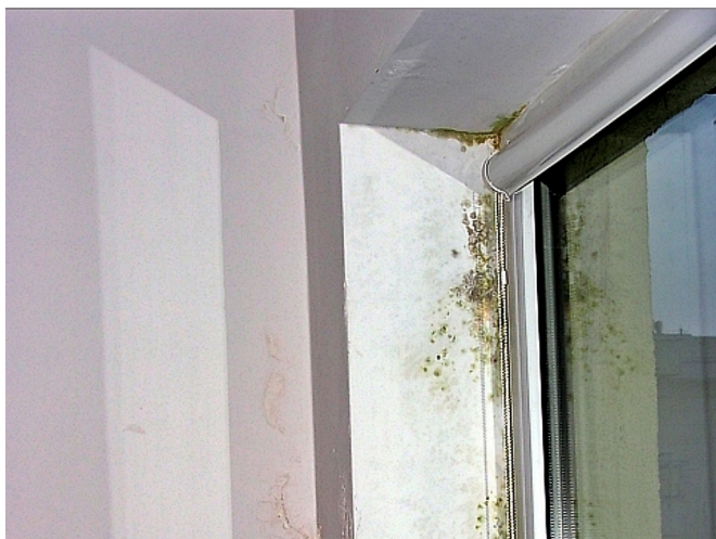
Fotografia 1. Przykład pleśni w ościeżu okna. Źródło: opracowanie własne Photo 1. Example of mold in a window frame. Source: authors' own study
